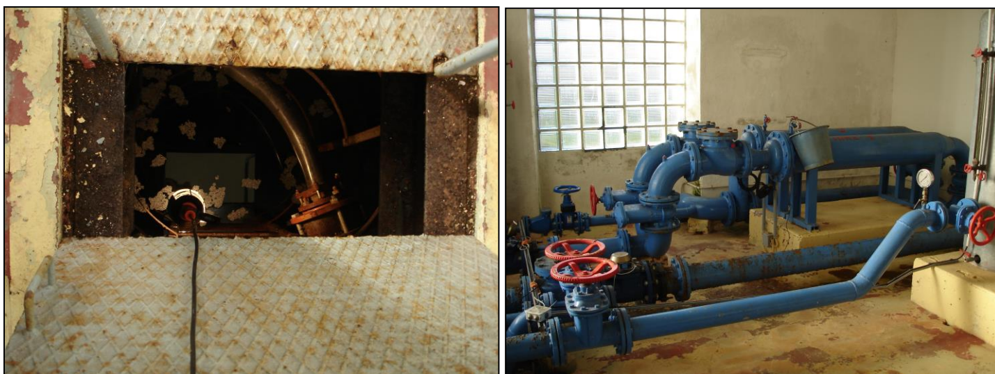
Photos 1 : Vue intérieure du captage et des deux pompes
